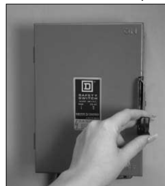
Boîte de disjonction
