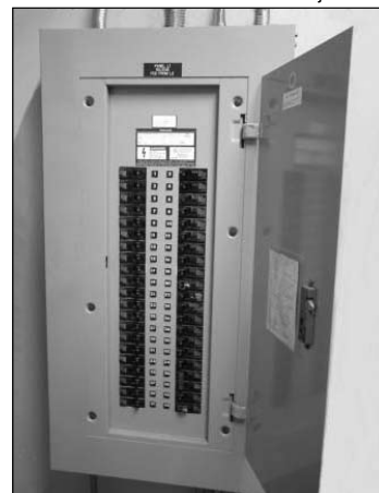
Panneau de disjoncteurs
